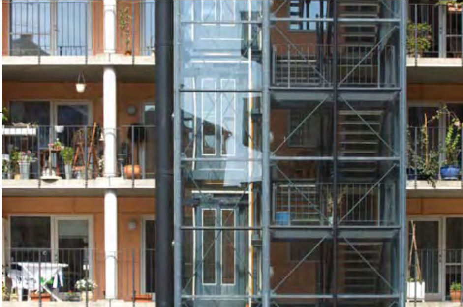
Det Nye Etagehus, Søfronten, Frederiksberg Det fleksible søjle-plade system er tydeligt eksponeret i facaden.
