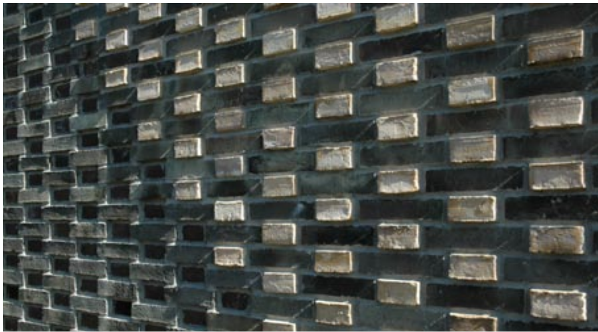
Kunstneren Bjørn Nørgaard og arkitekten Tage Lyneborg udfolder til fulde potentialiet i mønstermurværk i et nyopført sommerhus i Tisvilde. Her vises udsnit af husets rigt detaljerede base- og terrassemur, hvor de gule kopsten blot er trukket en anelse ud i forhold til resten af mængden af både glaserede sten, formsten og de iltreducerede grå sten. FOTO : KJELD VINDUM
