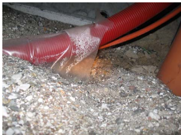
Figur 81 Membranen under gruset er løftet op, synlig fugt
