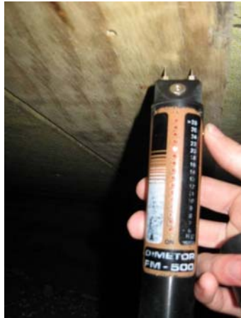
Figur 89 Fugtmåler viser 20 % fugt, Træet er misfarvet
