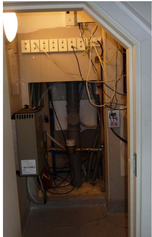
Figur 62 Installationsrum er placeret under trappe
