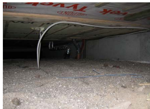
Figur 79 delvis fugtspærre under gruset, isolering er defekt
