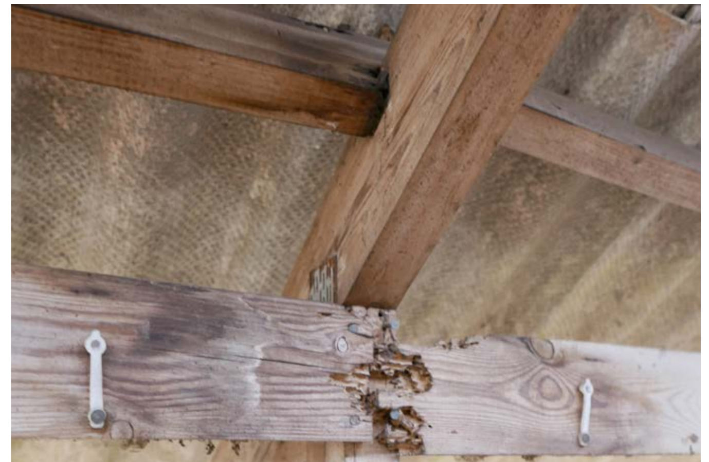
Konstruksjon og insektsskade i minkhall, Tranekær gård. Egne foto.
