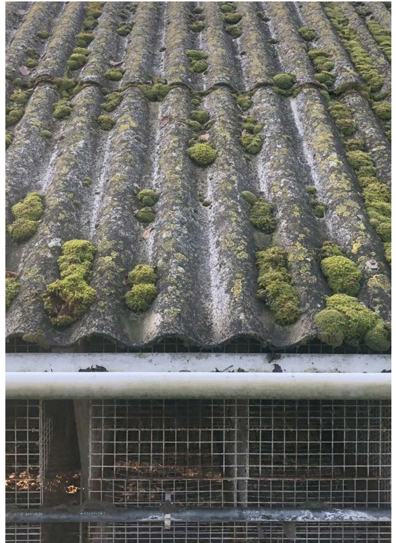
Mose på minkhallenes eternittak. Eget foto.
