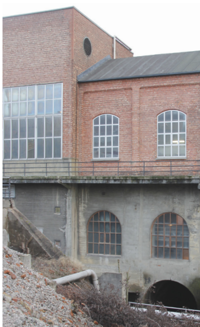
Borregaard kraftverk fra 1898 møter en nyere bygningsdel. Vinduene i sokkelen er formodelig opprinnelige støpejernsvinduer.
