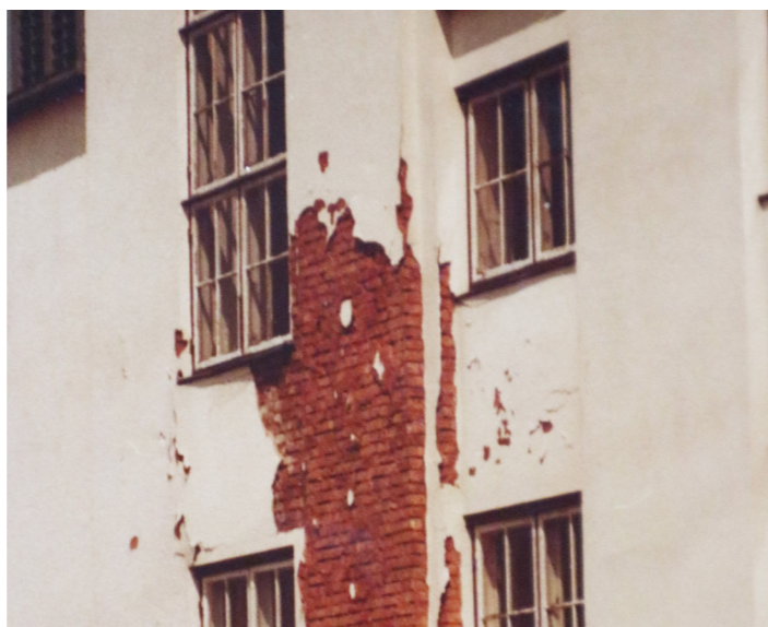
Under den hvide puds gemmer sig røde tegl. Fotografiet viser desuden de oprindelige hvidmalede flersprossede trævinduer. Arkivfoto.
