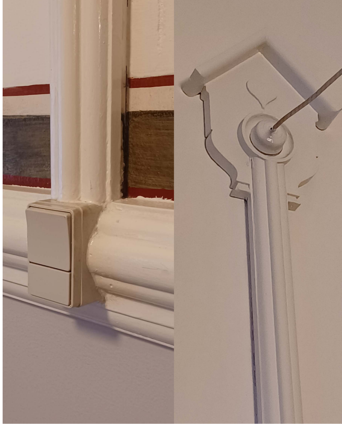
Københavns Rådhus, Martin Nyrop, ledningsføring i vægglister
