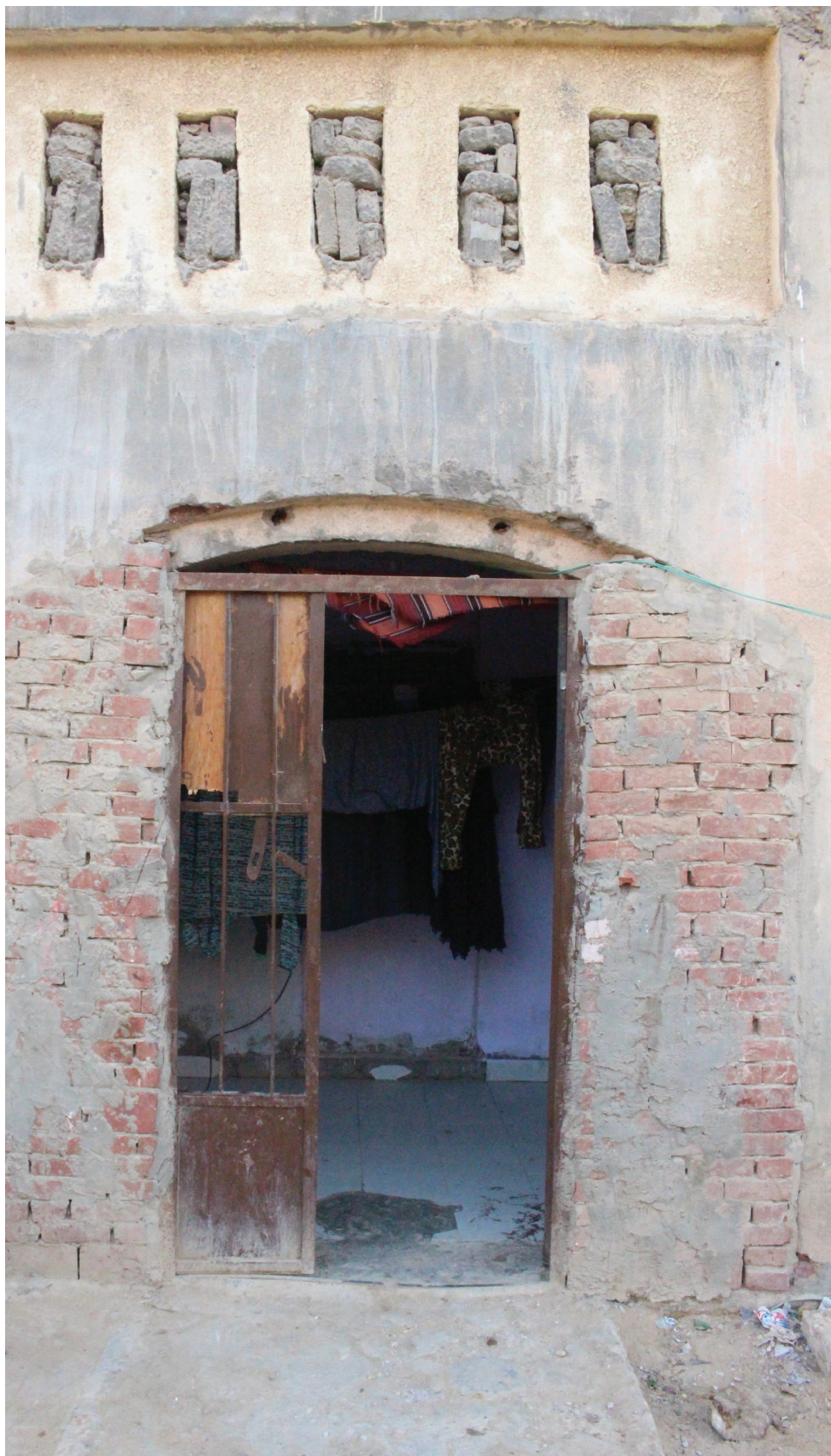
Billedet illustrerer indgangspartiet til en stueejlighed i Haram City. Væggens mørtel er nogle steder slidt væk, og de røde mursten står frem.
