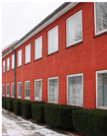
Figur 6: Den rødkalkede vestfacade, med støbejernsvinduer og saltskader.
