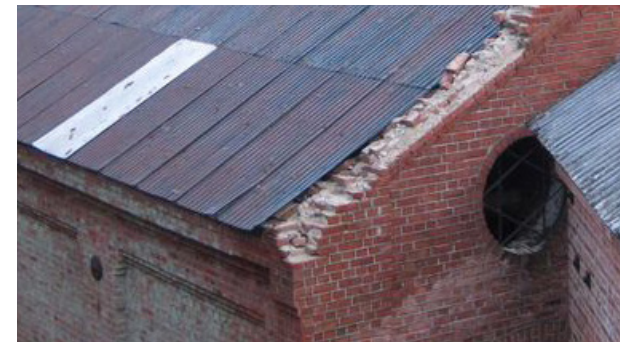
Over: Forfall på tørkehusets sydvestlige gavl, foto av Torggrim Landsverk, gjengitt med tillatelse Venstre: Gavlvinduet i tresliperiet, foto av Torggrim Landsverk, gjengitt med tillatelse
