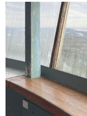
Detalje stolpe på bordplate ved vindu
