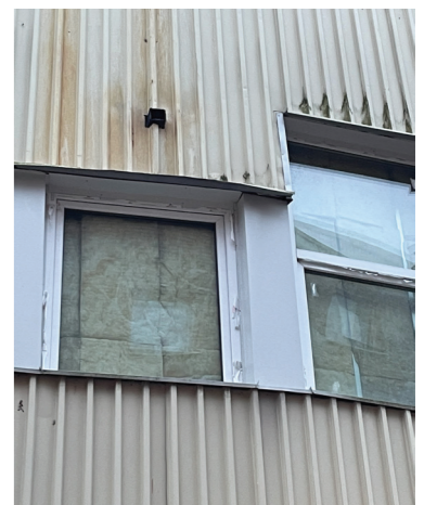
Nogle steder er vinduerne blevet lukket til indefra og fyldt ud med mineraluld, synligt fra gaden.
