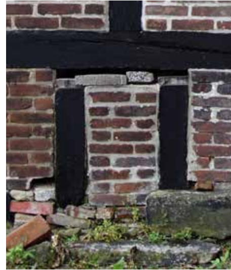
Tavl og bindingsværk der bør restaureres.
