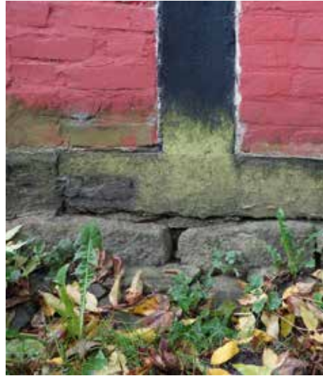
Norsidens fodrem trænger til udskiftning.
