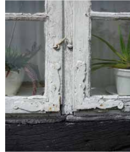
Vindue der trænger til vedligeholdelse.
